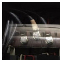
配線の異常発熱
